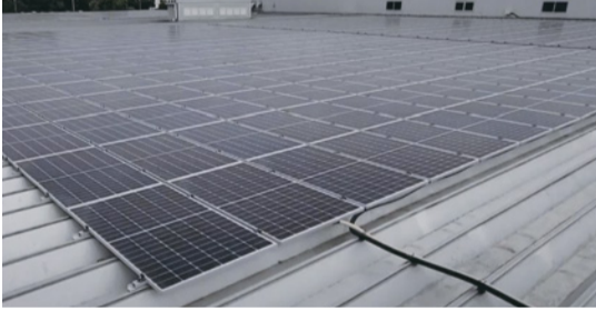
本社屋上の太陽光パネル
