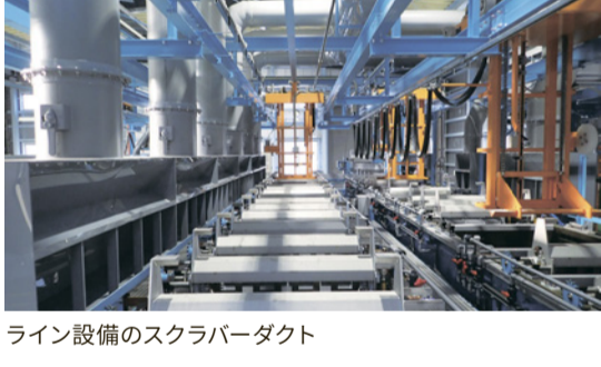
ライン設備のスクラバーダクト
